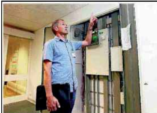
Urs Studer erläutert die Mängel bei den elektrischen Einrichtungen.
